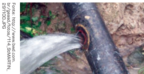
Vazamento provocado por corrosão de tubo
