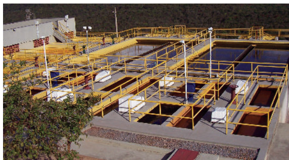
Estação de tratamento de água
