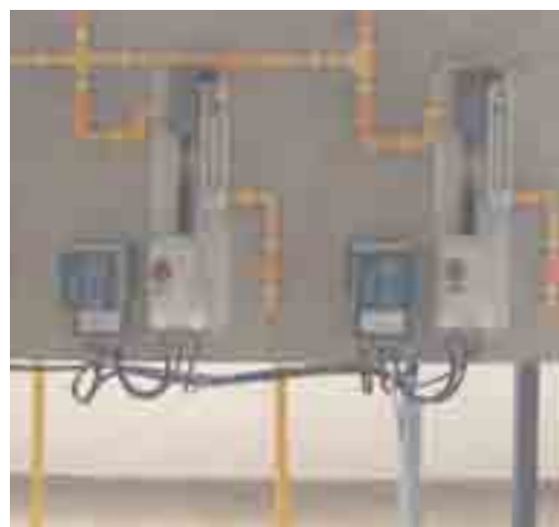
Dosadores de cloro
