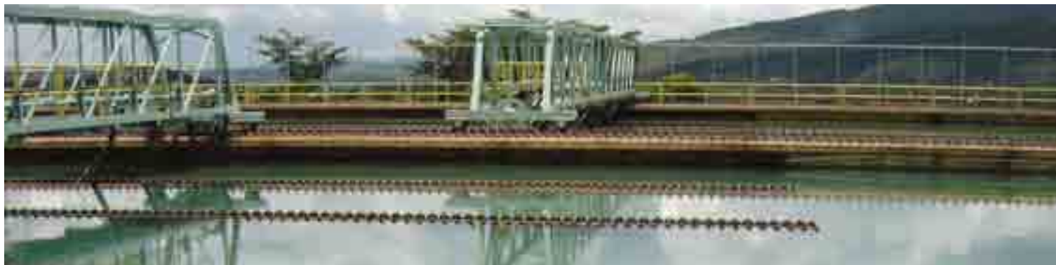
Decantador com ponte rolante com raspador
