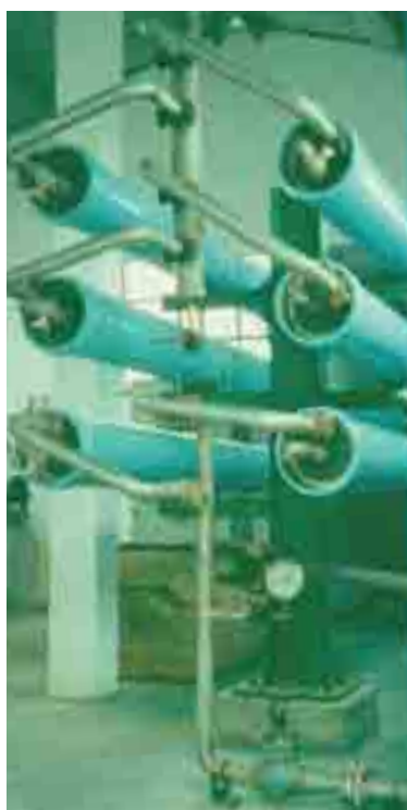
Filtração em membranas
