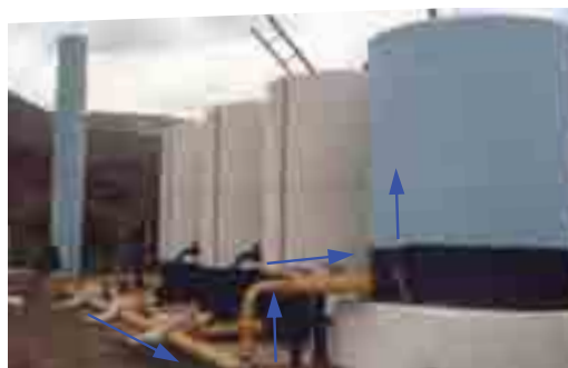
Agrotóxico filtração direta ascendente
