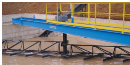
Desarenador de limpeza mecanizada
