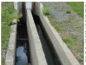
Caixa de areia de limpeza manual
