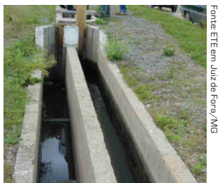
Caixa de areia de limpeza manual
