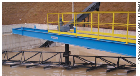
Desarenador de limpeza mecanizado
